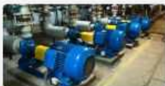
Salle des compresseurs
