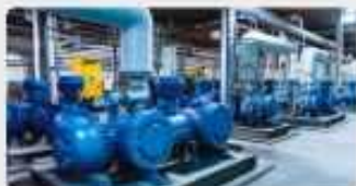
Zone de pompage
